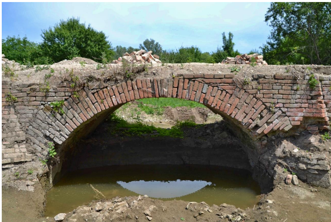
Obr. P1.25: Pohled na typické pole mostu před obnovou – chybí část zdiva pilířů, několik cihel v klenbě a prakticky celá horní část mostu – zábradelní zdi.
