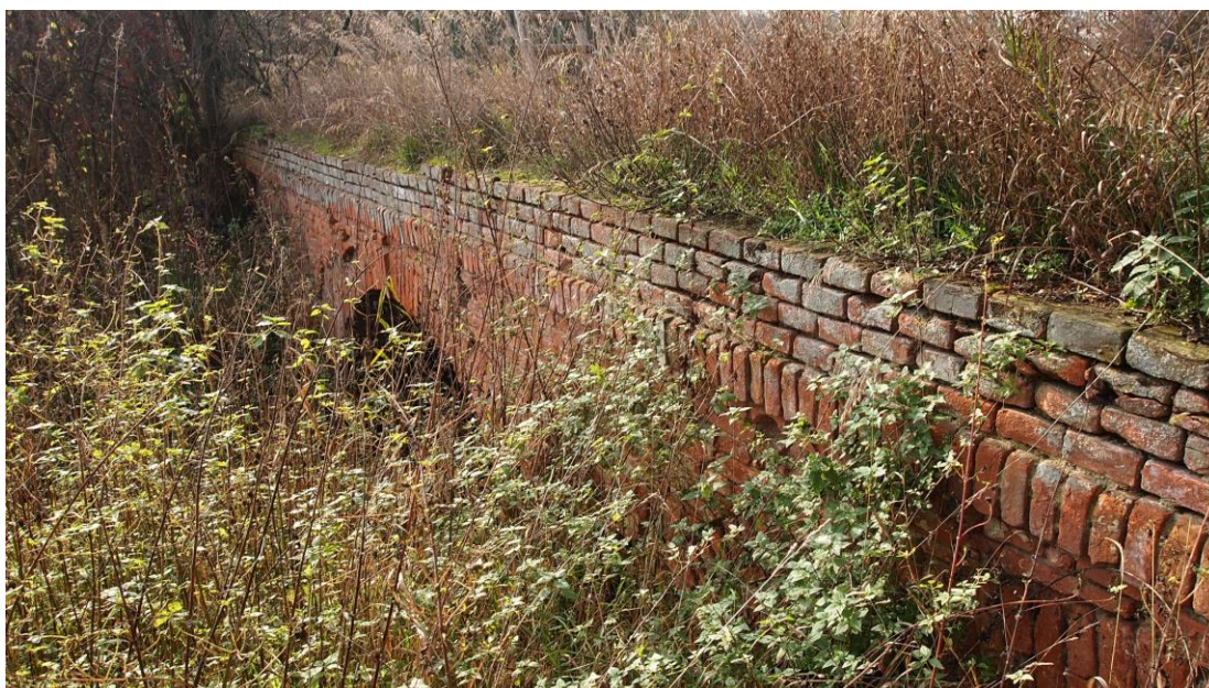
Obr. P1.2: Stav mostu před obnovou – od stavby železnice a zasypaní části rybníka ve 2. pol. 19. století most postupně mizel v nánosech bahna a zarůstal vegetací, část cihel zejména ze zábradelní zdi byla rozebrána.
