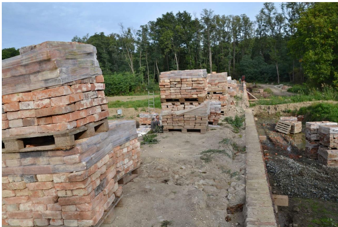
Obr. P1.26: Stav mostu před obnovou – od stavby železnice a zasypaní části rybníka ve 2. pol. 19. století most postupně mizel v nánosoch bahna a zarůstal vegetací, část cihel zejména ze zábradelní zdi byla rozebrána.
